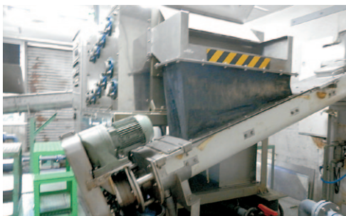
JWケミテック株式会社戸塚工場 脱水機
