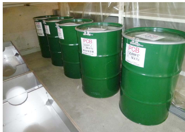
PCB保管場所(厚木研究開発センタ)
