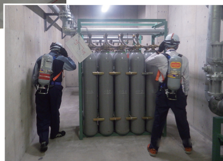
ハロンガス漏えい時緊急措置訓練 (武蔵野研究開発センタ)
