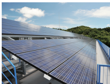
太陽光発電システム (厚木研究開発センタ)
