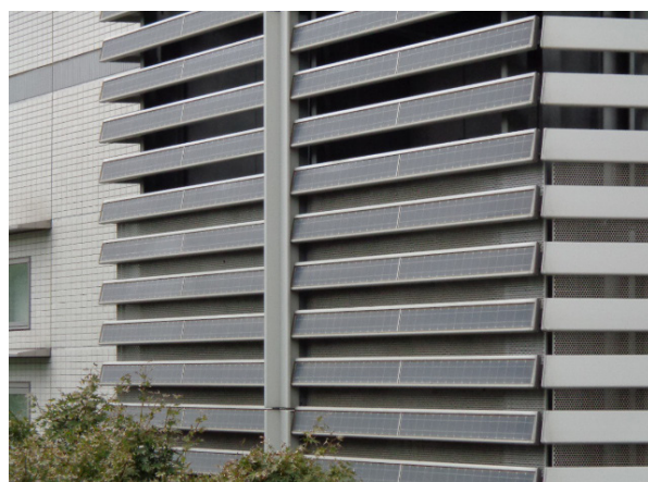
太陽光発電システム (武蔵野)
