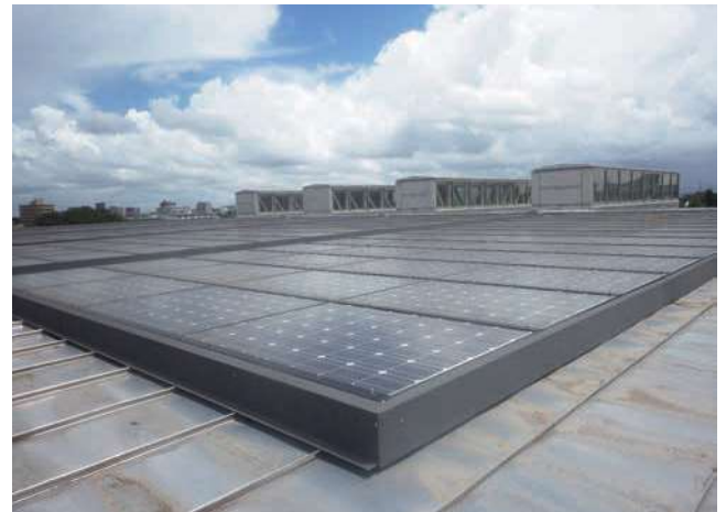
太陽光発電システム(武蔵野技術史料館屋上)
