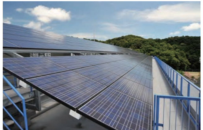
太陽光発電システム（厚木研究開発センタ）
