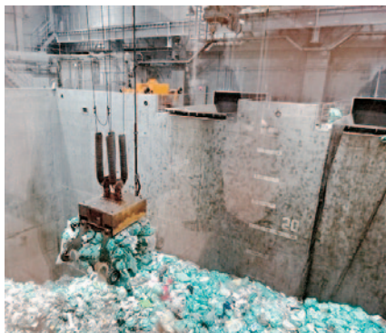
武蔵野クリーンセンター 可燃ごみピット
