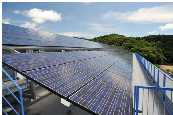
太陽光発電システム（厚木研究開発センタ）
